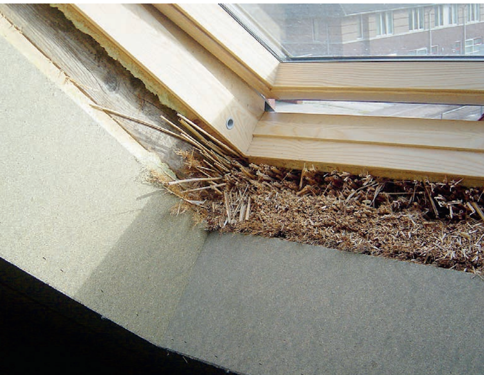
Dakvensteraansluiting in een rieten dak. Zo moet het dus niet!
