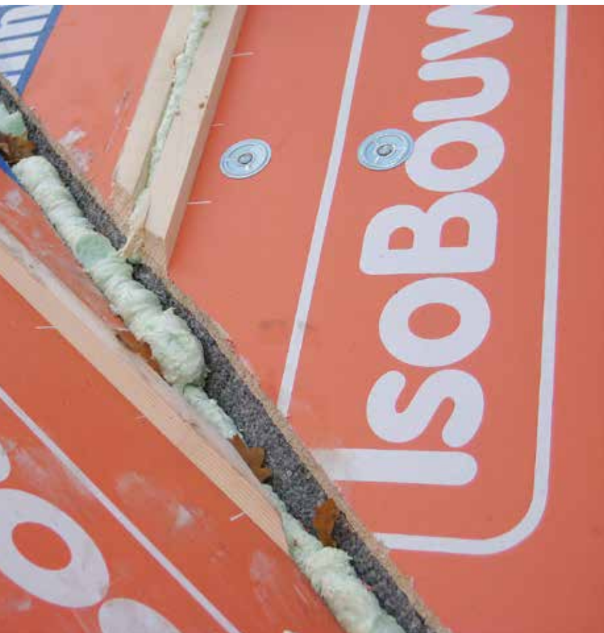
Kilkeper sluit niet lekker aan...
