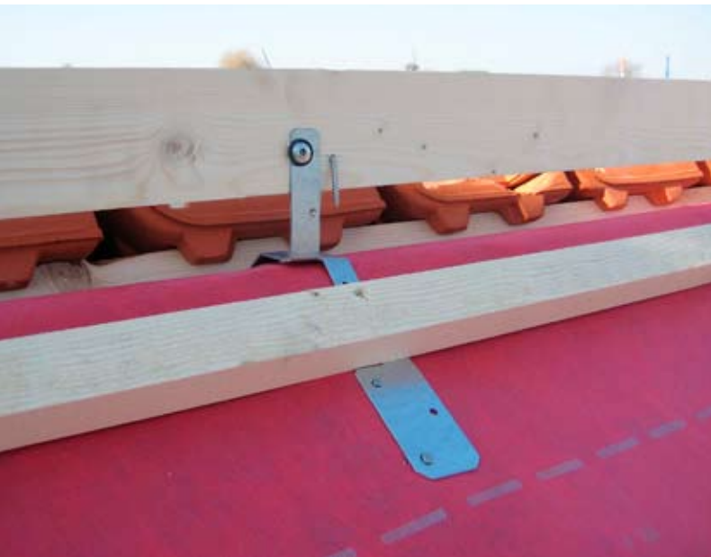
De ruiter draagt niet in de steun en de steun is niet goed bevestigd.
