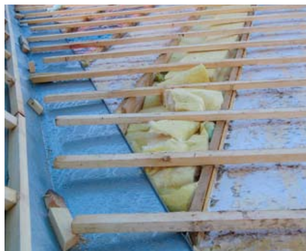
De isolatie in de kilconstructie van dit woningscheidende detail zal weinig effectief zijn.
